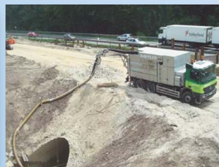
Odsávání z tunelu pod dálnicí
